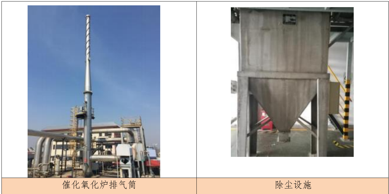
图 1.4 主要废气处理设施
