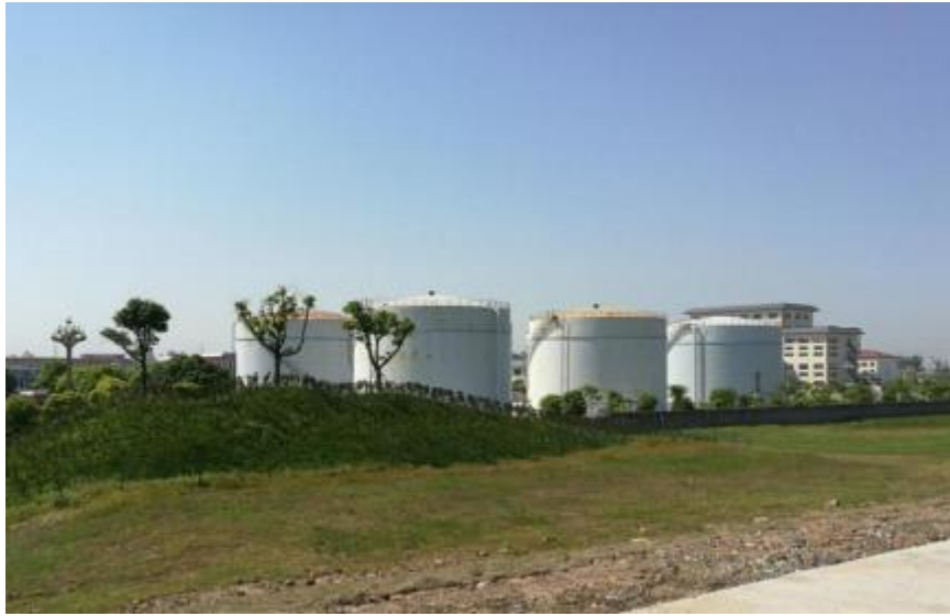
依托国星公司 5000m 3 事故应急罐
